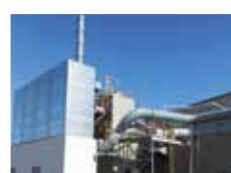
Esta casa de filtros elimina la contaminación del aire y captura partículas de metales preciosos.
